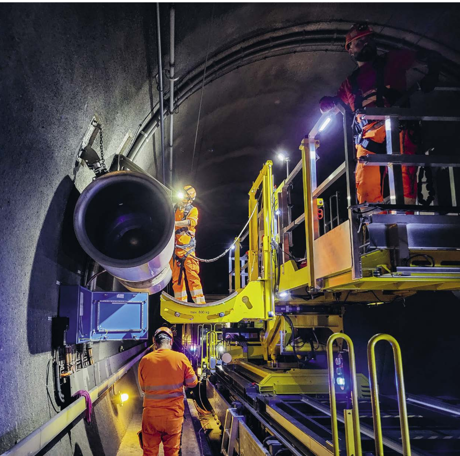
NFTA: Veicolo di manutenzione nella galleria di base del San Gottardo
